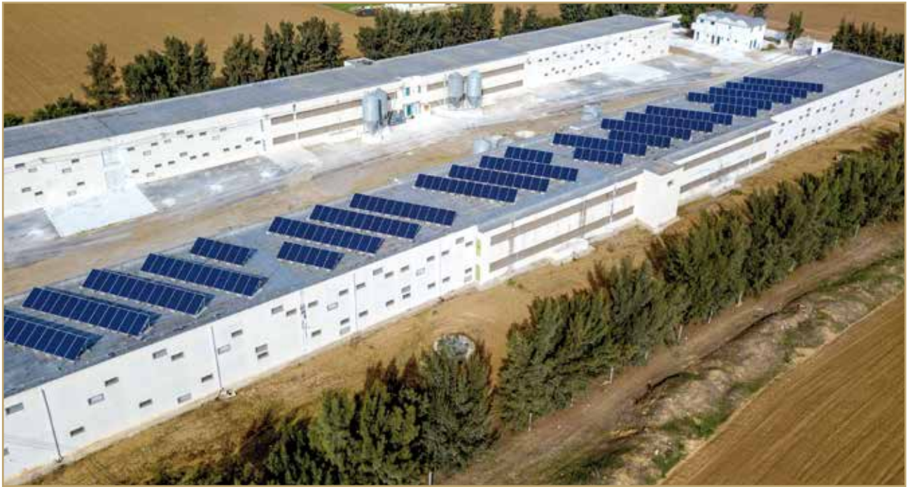
Installations de cogénération dans une usine de matériaux de construction
